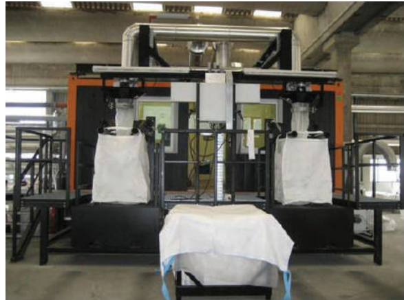
Рисунок 2 – Установка охлаждения и затаривания битума в Пёрнер Битумен Бэг
