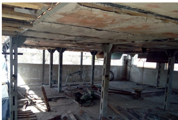
Рисунок 1 – Рамный стальной каркас из швеллеров “в короб” (строящееся кафе в г. Бишкек)
